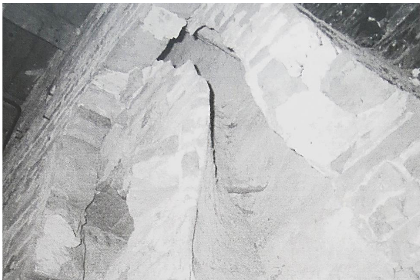
Afb. 7. Een warme luchtkanaal van onderen gezien, met het donkere rookkanaal uiterst rechtsboven op de foto. Het luchtkanaal loopt dicht langs het rookkanaal om te profiteren van de warmte van de laatste.
